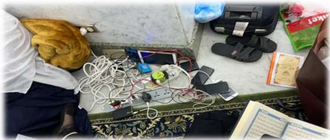
شكل (12) أسلاك وتوصيلات وعفش زائد جولات الباحث الميدانية
